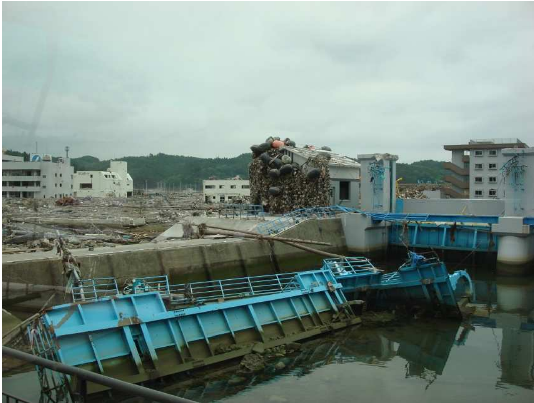
南三陸町 破壊された水門 屋上に引っ掛かったブイ
